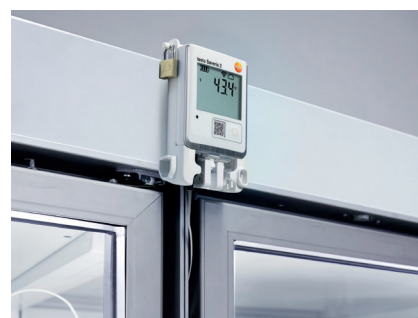
Monitoraggio dell'ultracongelatore in un laboratorio (testo Saveris 2-T3 con sonda di temperatura)
